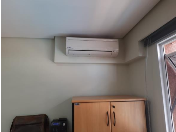
Figura 13 – Evaporadora para ser retirada – Sala do Atendimento – Nesse local não será instalada outra.
