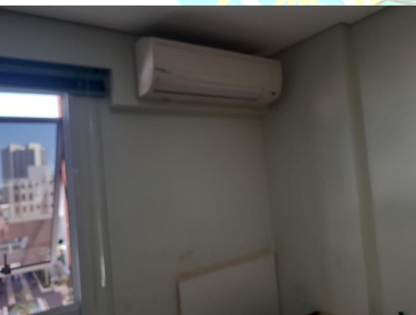
Figura 5 - Evaporadora para ser retirada e substituída pela nova – Sala de Atendimento
