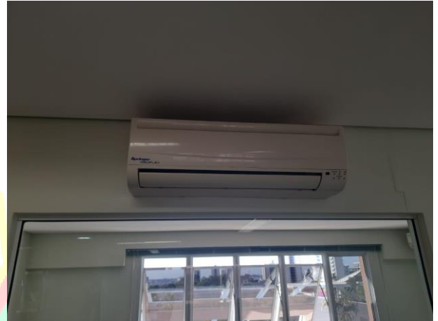
Figura 2 – Evaporadora mais distante da condensadora, em torno de 10 metros. -
