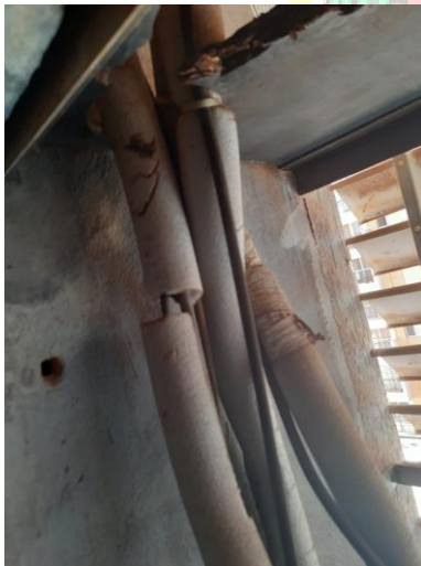
Figura 9 – Dutos instalados e isolados em conjunto – Sala do Atendimento
